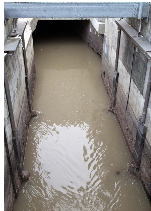
Der Gesamtzufluss wird schon lange mit einer fest installierten berührungslosen akustischen Messstelle (Ultraschall-Laufzeit) erhoben.
