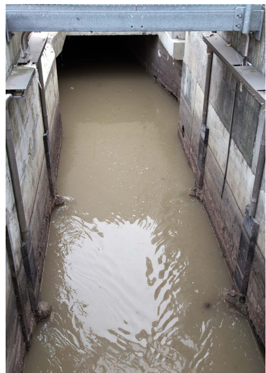
Der Gesamtzufluss wird schon lange mit einer fest installierten berührunglosen akustischen Messstelle (Ultraschall-Laufzeit) erhoben.
