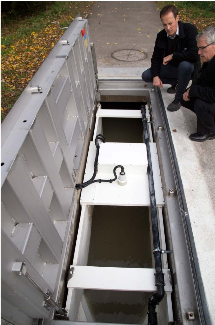
Thomas Di Lorenzo und Andreas Zingg (STEBATEC) betrachten die neu installierte teilgefüllte stationäre Durchflussmessung am einen Hauptsammelkanal.
