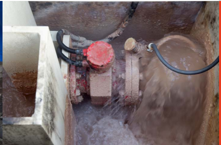
Das Abwasser durchströmt den Durchflussmesser. Die Probenahmen gelangen über den Schlauch rechts in die Sammelbehälter.
