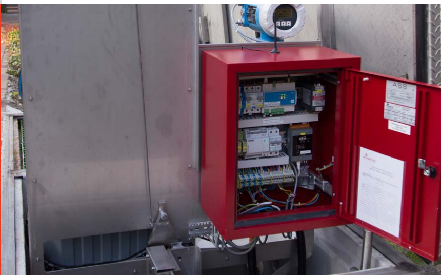
Auch der Zugang zum Steuerschrank ist uneingeschränkt möglich.
