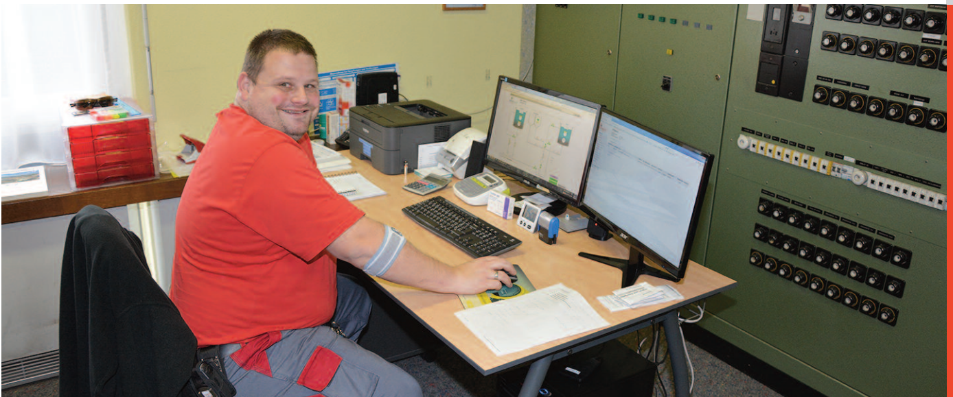
Klärwärter Michel Hess der ARA am Twannbach steuert die Anlage per ARAbella online in der Cloud.
