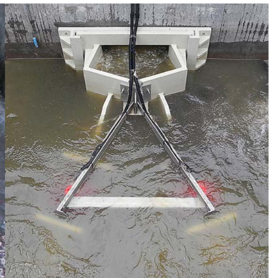
Zulaufmessung in Betrieb
