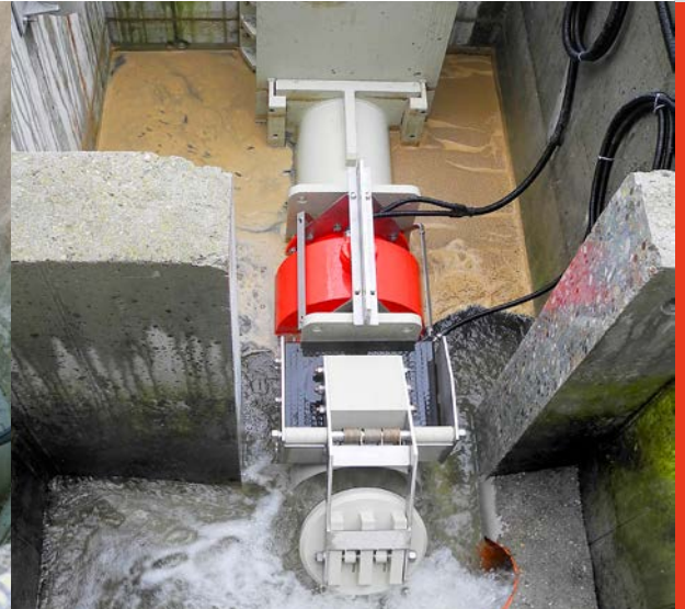
Abflussregelung zur Füllstandregelung Nachklärbecken (Reinwasserabzug über Tauchrohr) in Betrieb
