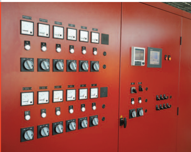
Detailaufnahme der neuen Hauptverteilung.
