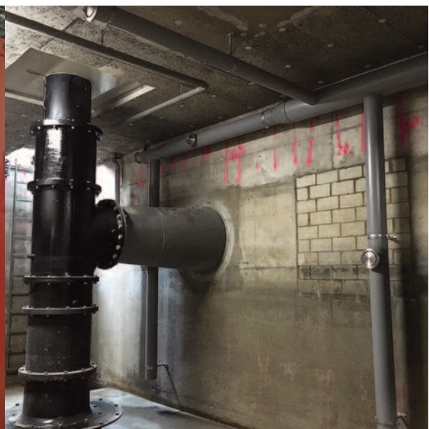
In der ATEX-Zone sorgt eine neue Abluftanlage (graue Röhren an Wand und Decke) für stets sichere Verhältnisse.
