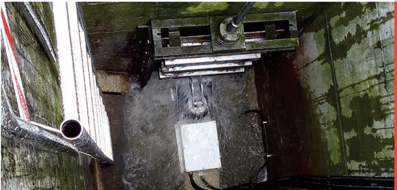
Der teilgefüllte pneumatische Abflussregler misst und begrenzt die Durchflussmenge dynamisch.
