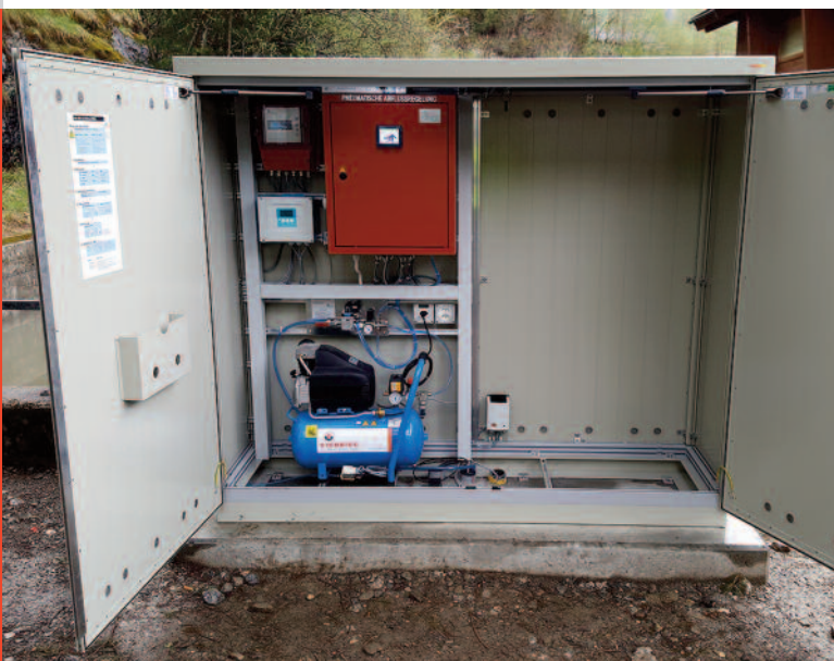
Blick in die Kabine mit dem Schaltschrank der pneumatischen Abflussregelung des Regenüberlaufbeckens Galgenbühl.
